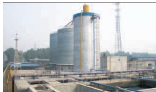
■河南驻马店天方生物工程有限公司淀粉废水处理
